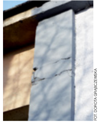
Słup oddzielający część budynku, w którym jest świetlica, został tylko pomalowany. Nie zaprawiono, nie wyrównano nawet pęknięcia.
