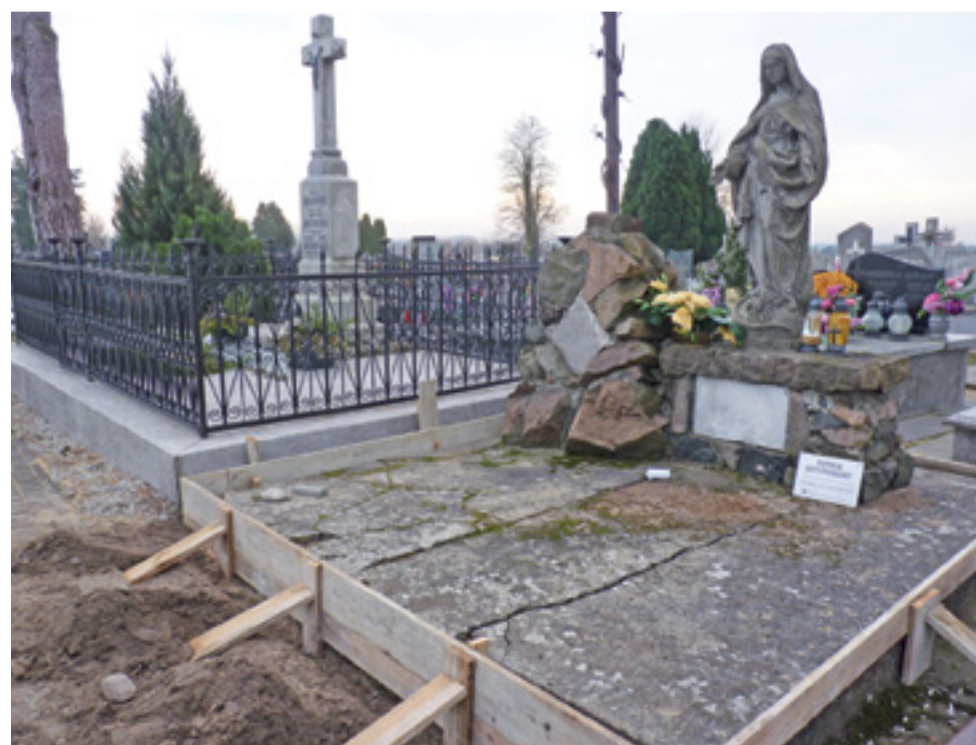
1 grudnia zastaliśmy starą, mocno popękaną płytę grobu Józefa Fijałkowskiego wyszalowaną, by zalać wszystko nowym betonem. Początkowo planowano, że betonowy postument zostanie rozbito, a na jego miejsce wylany nowy. Wykonawcy poszli na skróty. Pierwsze efekty w postaci spękań już widać.
