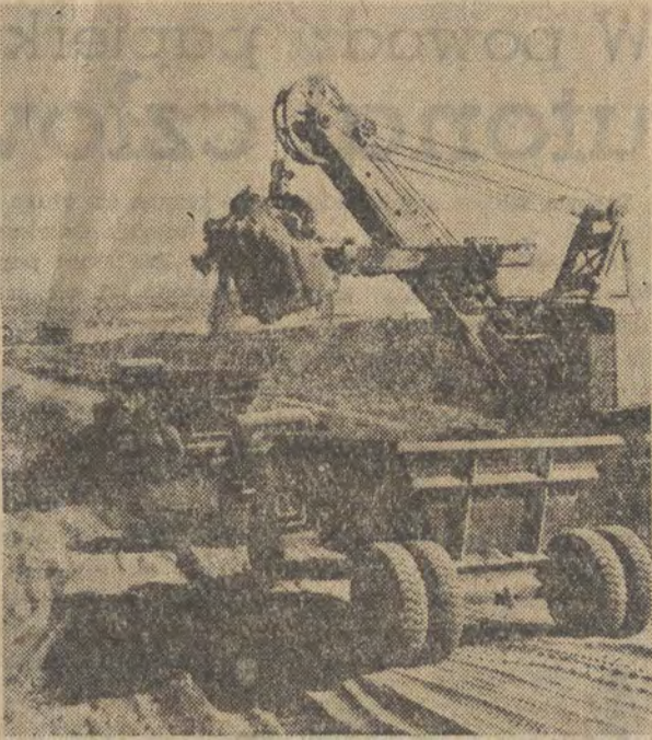
W okręgu Tachla-Tasz trwa budowa kanałów okrężnego i łączącego. Kanał okrężny rozpoczyna się od lewego brzegu Amu-Darji i omijając Tachla-Tasz, wychodzi na trasę głównego Kanału Turku meńskiego. Na zdjęciu: fragment budowy okrężnego kanału Tachla-Tasz. Fot. — CAF
