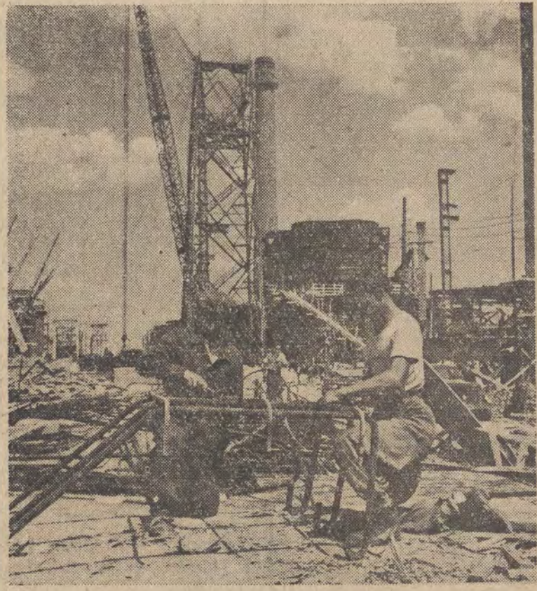
METALOWCY BUDUJĄCY KOMBINAT NOWA HUTA — PRACUJĄ NA UPO- RZĄDKOWANYCH WZGLĘDACH. Brygada zbrojarzy Władysława Boquckiego pracując na uporządkowanych normach wyrabia już 140 proc. normy. Na zdjęciu: brygadziści Władysław Boqucki i zbrojarz Franciszek Krzywda, w głębi: budowa wielkiego pieca. CAF — fot. Zygm. Wdowiński
