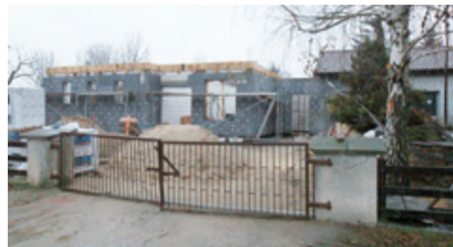
Tak prezentuje się nowa, do budowywanej do starej, część przedszkola samorządowego w Kiernozi.
