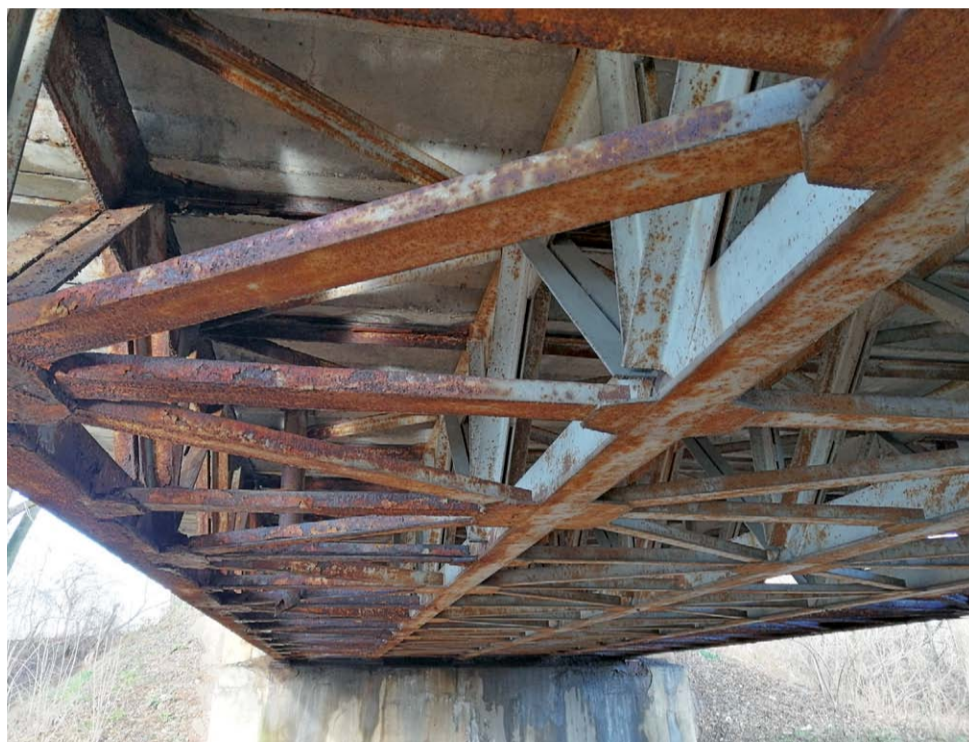
Skorodowany most nad Bzurą w Łowiczu. Na jego remont miasto chciało pozyskać pieniądze. Na razie bez efektu.
