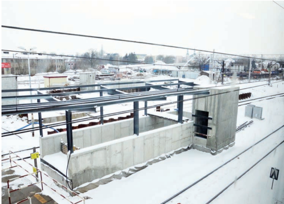
Widok na budowę, w tym zejście do podziemnego przejścia na perony, z perspektywy piętra dworca.
