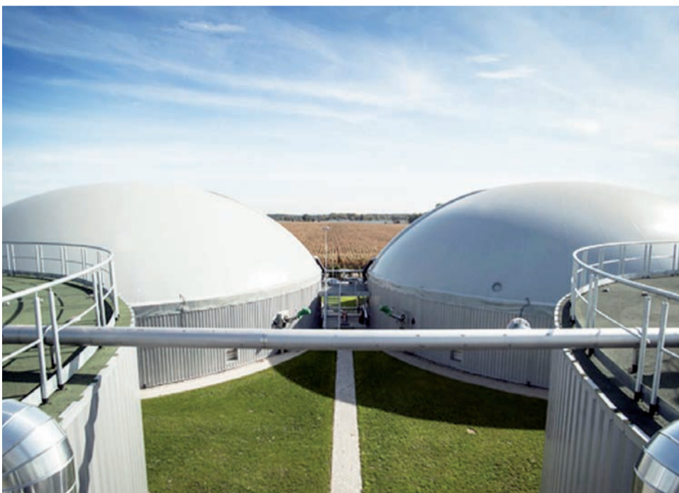
Biogazownia w Konopnicy wybudowana i zarządzana do 2020 roku przez inną spółkę Grzegorza Grzyba – BioEnergy Project.
