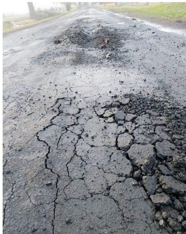
Droga wiodąca do Kęszyc została w wielu miejscach mocno uszkodzona przez ciężki transport. Na zdjęciu widać, że koła spowodowały głębokie koleiny.
