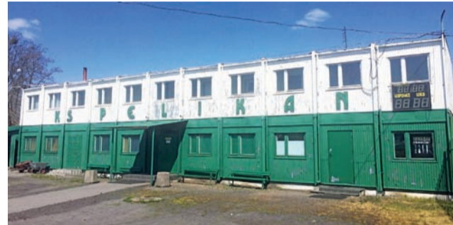
Od wielu lat wiadomo, że budynek zaplecza KS Pelikan nie wygląda dobrze ani na zewnątrz, ani od środka i nie spełnia już wymagań, jakie powinien.
