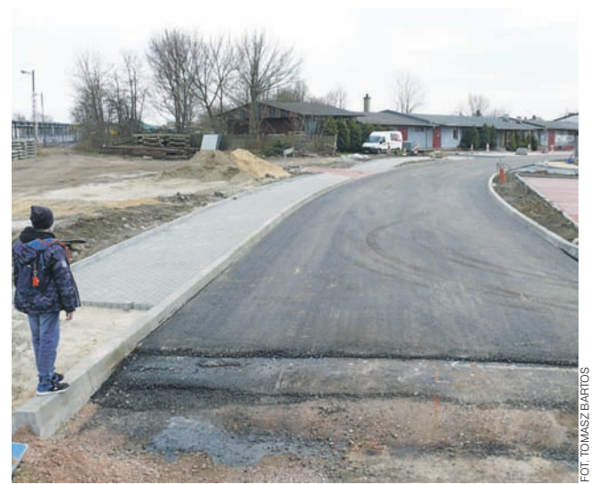
Ulica Napoleońska – widok w kierunku ul. Klickiego, na dole kadru wyraźnie widoczne dwie warstwy asfaltu.
