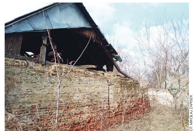
Ul. Zduńska. Podobna sytuacja jak na ul. Stanisławskiego – pożar strawił wnętrze budynku, ale okropna elewacja wciąż psuje wygląd centrum.
