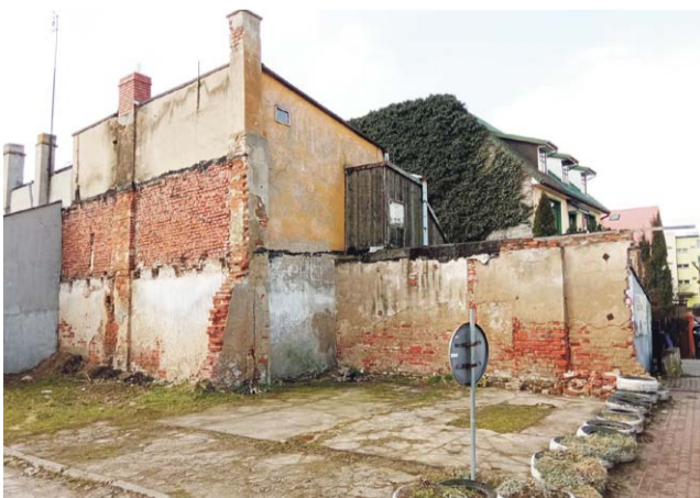
Przy ul. Sybiraków znajdują się nie tylko oficyny kamienic, ale również osobne zaniedbane budynki.
