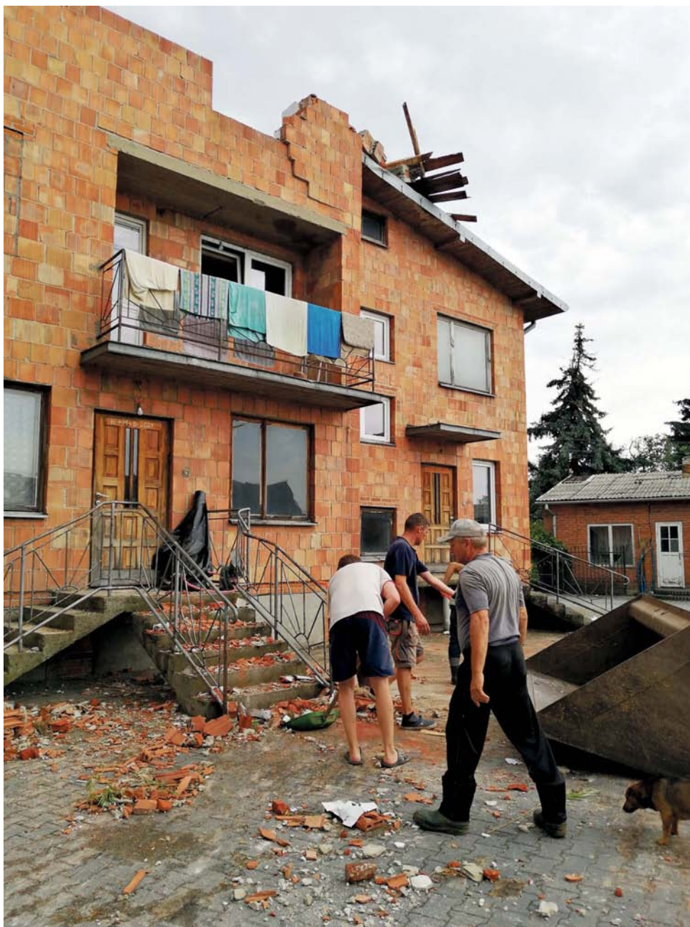
Rodzina i sąsiedzi Haliny Wojtysiak z Łażnik w gminie Zduny sprzątają podwórkę z cegieł, które spadły, gdy wiatr zerwał w nocy dach z połowy domu, a na drugiej połowie poważnie go uszkodził.
