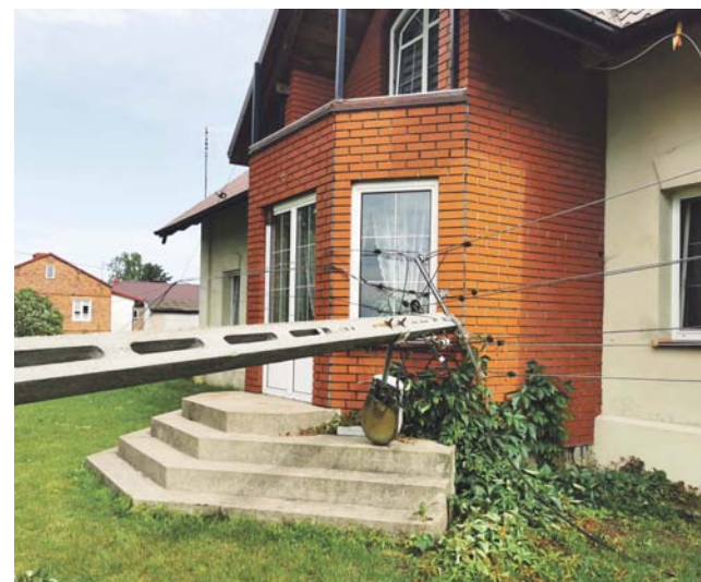
Złamany słup sieci energetycznej w Świerżu I.
