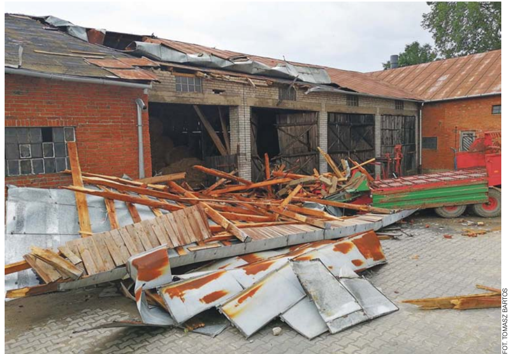
Podwórko pani Haliny Wojtysiak w Łążnikach: zerwany dach domu, który nie wybił dziury w dachu stodoły wyładował u jej wrót.
