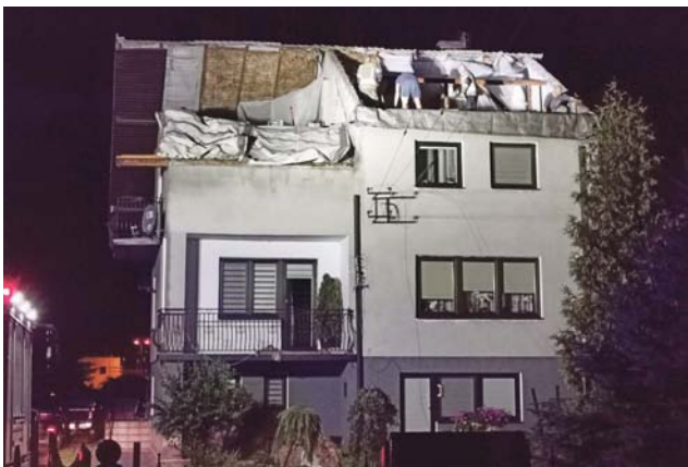
Zerwany dach domu przy ul. Łódzkiej w Łowiczu.
