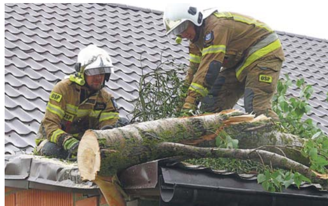
Ochotnicy z Pilaszkowa sprzątają konar, który oberwany z dużej topoli spadł na dach domu w Złakowie Borowym.
