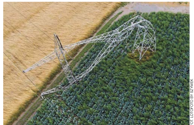
W gminie Sanniki wiatr łamał nawet wielkie słupy wysokiego napięcia.
