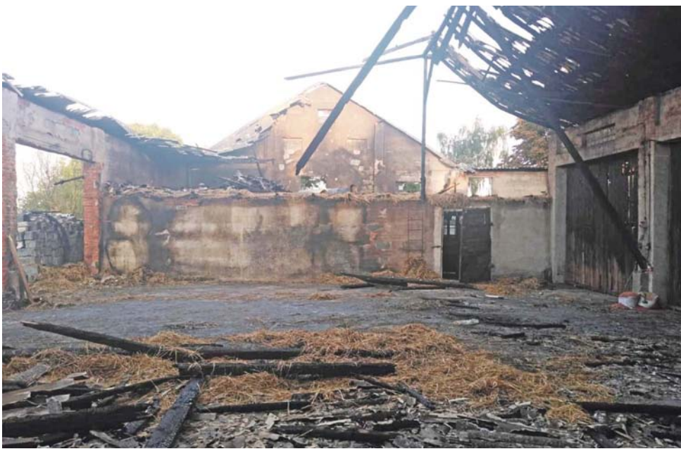
Widok pogorzeliska pokazuje, jak duży jest rozmiar strat. Zniszczeniu uległ budynek w kształcie litery L, spaleni uległo 250 balotów słomy i to, co gospodarze przechowywali w środku.
