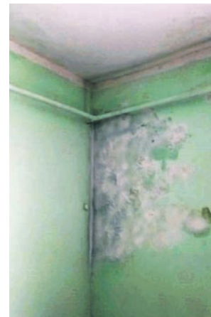
Po każdej ulewie ściany w pokoju wyglądają coraz gorzej.
