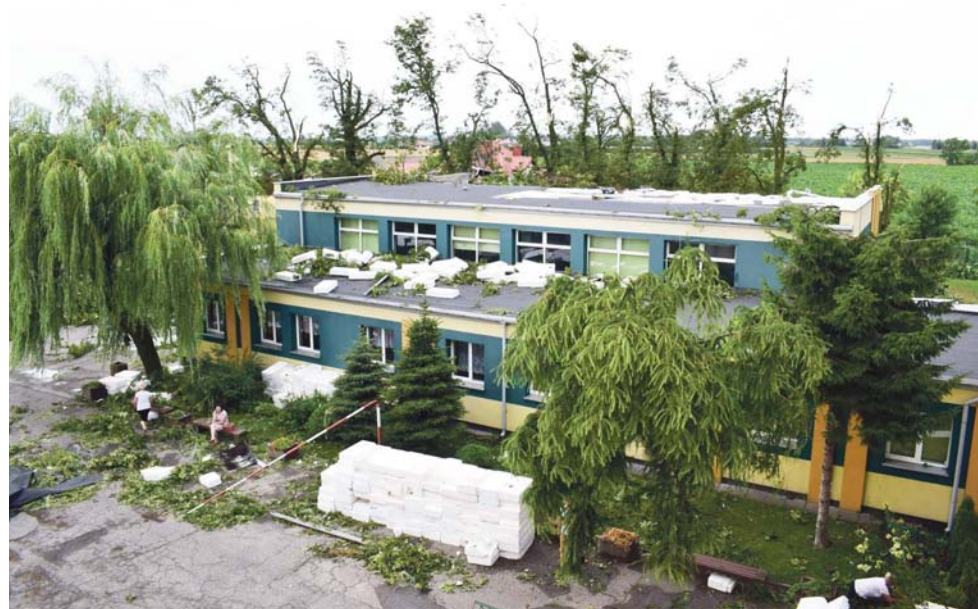
Budynek szkoły w Sannikach z widocznym uszkodzeniem dachu na sali gimnastycznej i rozrzuconym styropianem, który miał docieplać strop.
