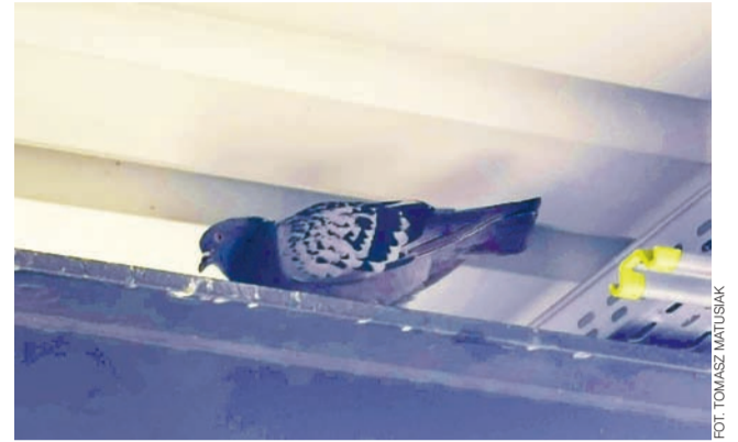
Ptaki korzystają z tego, że na elementach konstrukcji wiat na peronach nie zamontowano kolców.
