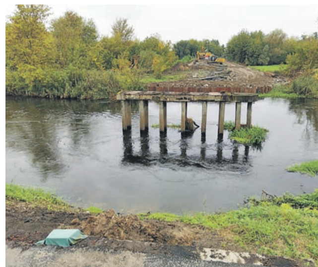
Charakterystyczny most w Kompinie zniknął z powierzchni ziemi.
