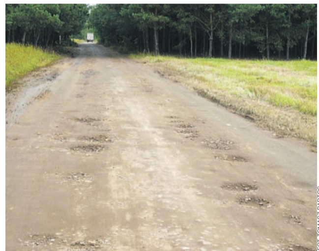
Droga wymaga co pewien czas naprawy. Asfalt aż się prosi, ale...
