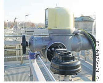
Oczyszczalnia ścieków w Łowiczu – część zmodernizowana.
