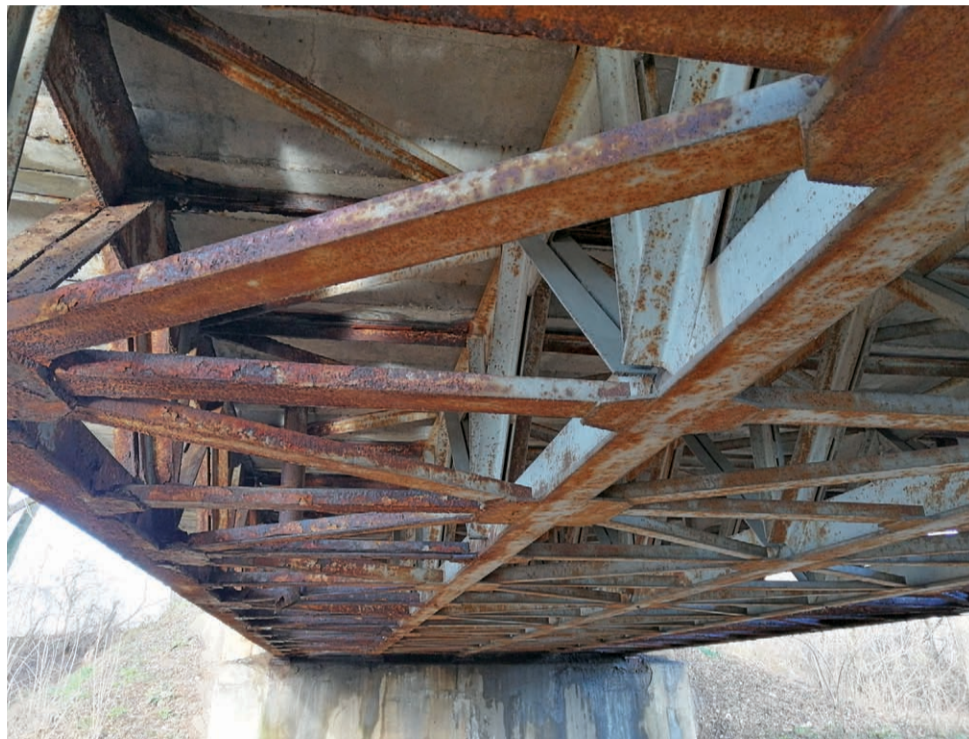
Skorodowany most nad Bzurą w Łowiczu. Na jego remont miasto chciało pozyskać pieniądze. Na razie bez efektu.
