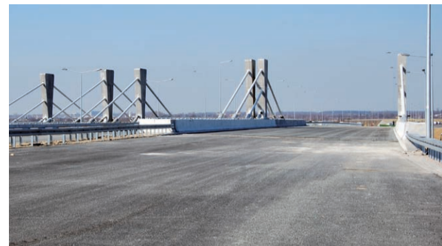
Od razu po stwierdzeniu pęknięć GDDKiA postanowiła wyłączyć wiadukt z ruchu.
