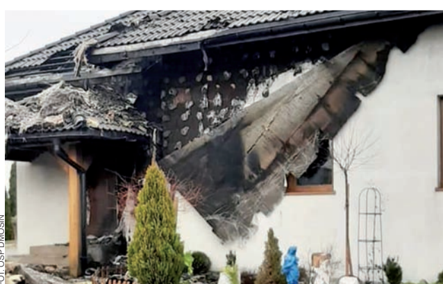
W wyniku pożaru poważnie uszkodzony został dach na budynku.
