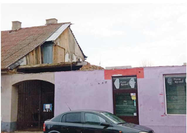
Ul. Stanisławskiego 11. Od pożaru minęło parę lat, a budynek jak się rozpadł, tak robi to dalej.
