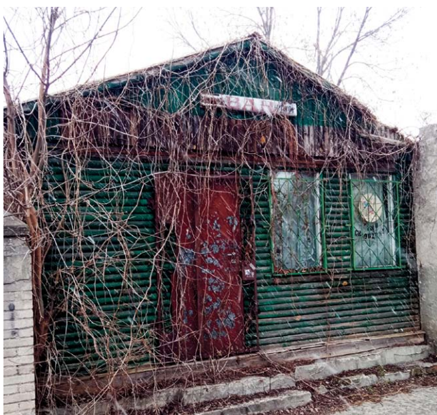
Bar przy ul. Wąskiej. Z czasów, gdy tętnił on życiem, pozostały już tylko wspomnienia i rozpadające się drewniane ściany.
