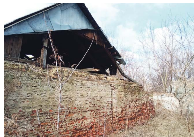
Ul. Zduńska. Podobna sytuacja jak na ul. Stanisławskiego – pożar strawił wnętrze budynku, ale okropna elewacja wciąż psuje wygląd centrum.
