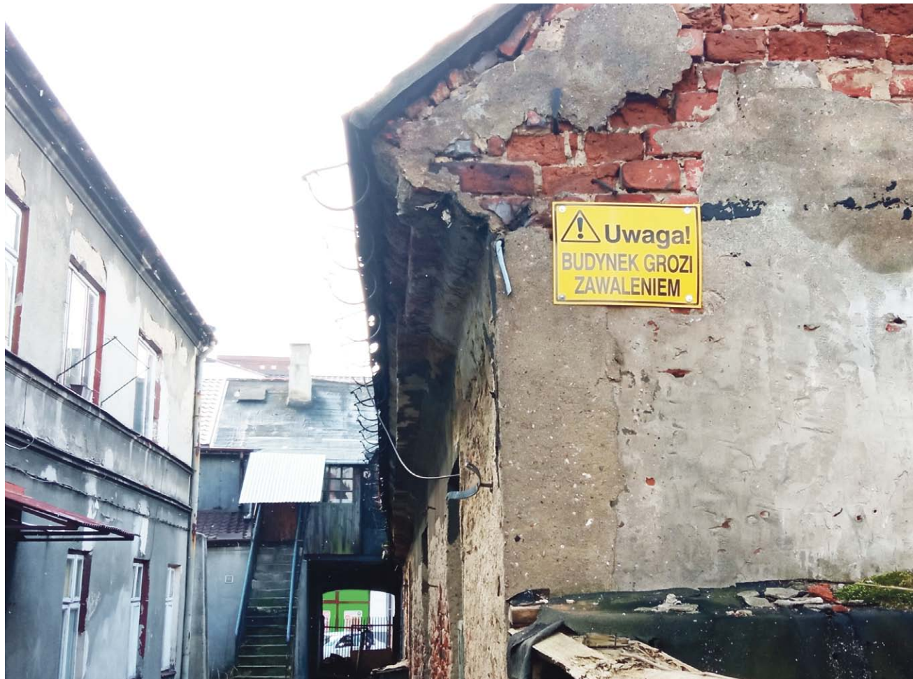
To nie jedyna tabliczka ostrzegająca o złym stanie budynku. Pozostałe zwracają uwagę na spadający tynk lub istniejące niebezpieczeństwo.
