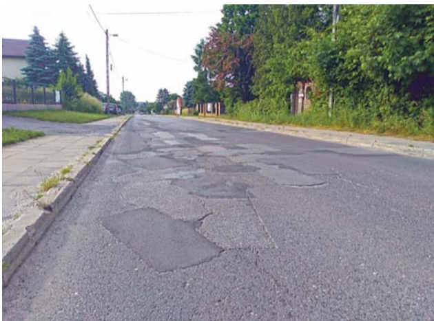
Dotychczasowa nawierzchnia wymaga już wymiany. Widok na ul. Bielawską w kierunku ul. Kilińskiego.
