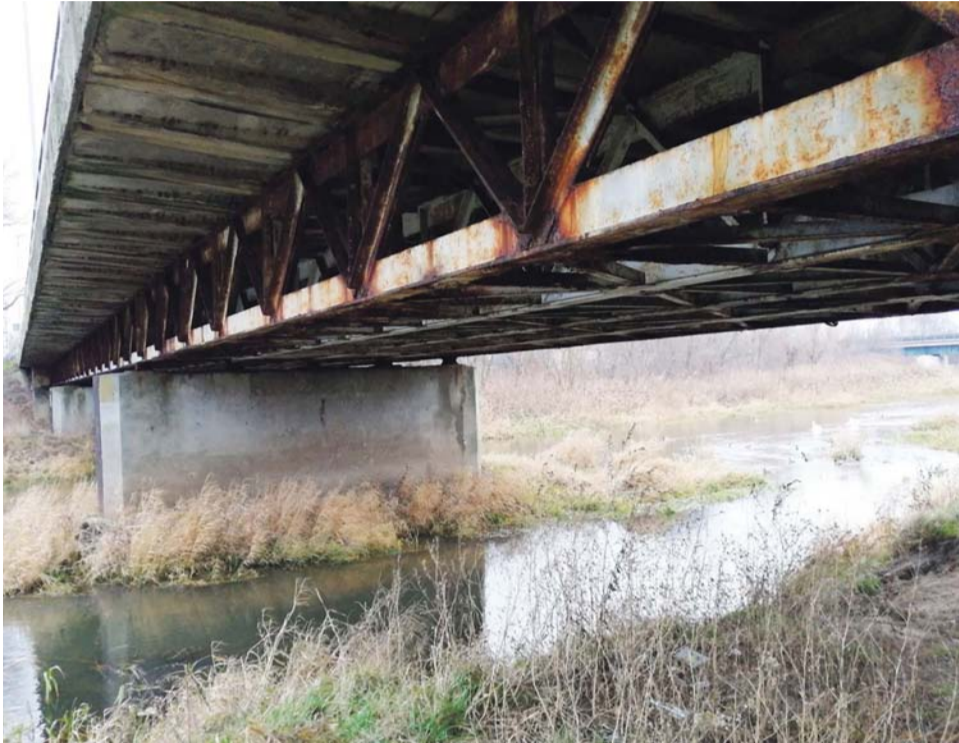
Stary, skorodowany most na Bzurze w centrum Łowicza. Jego modernizacja wydaje się być jednym z priorytetów.
