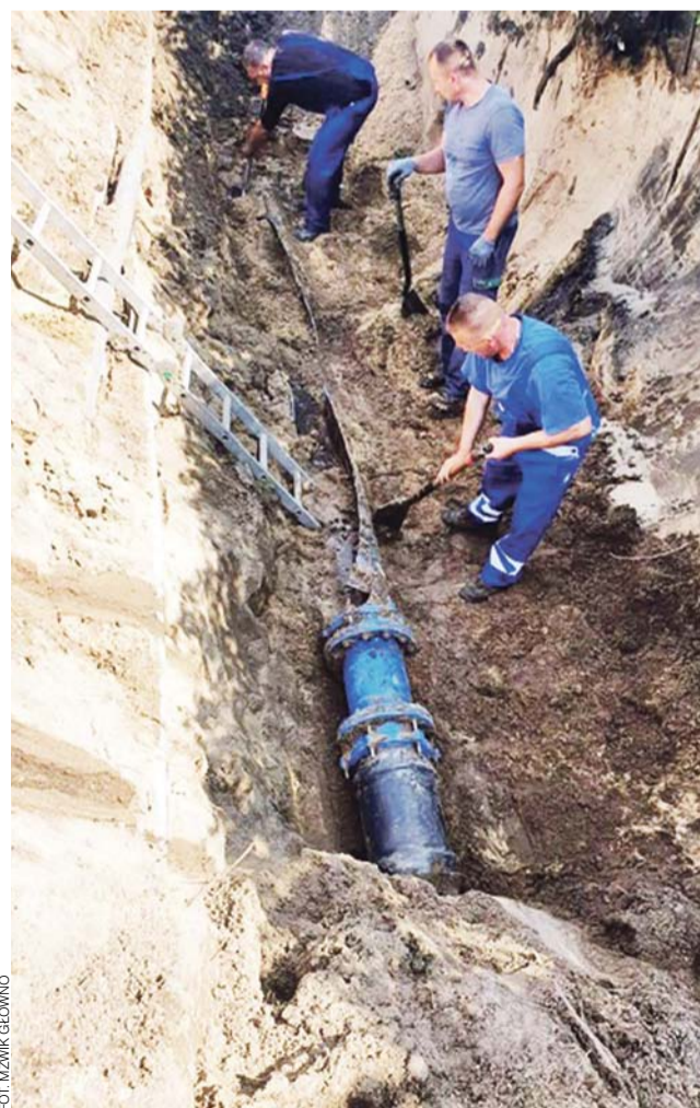
Rura wodociągowa pękła na długości kilku metrów.
