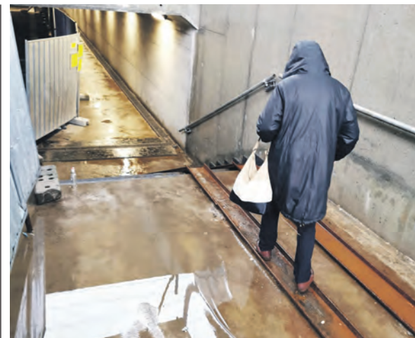
Na schodach wiodących do tunelu pod torami przy dworcu Łowicz Główny stoi woda, a tak radzą sobie z jej obecnością mieszkańcy miasta i podróżni.
