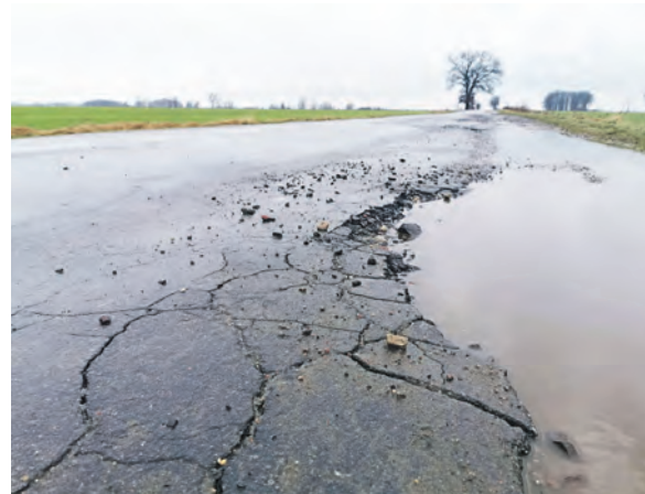
Popękany asfalt, zarwane pobocza, wąsko – to stan drogi Sobota – Bąków na odcinku od Soboty do Leśniczówki.
