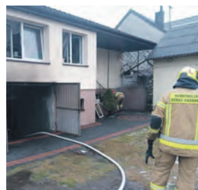
Do pożaru doszło w piwnicy w kotłowni.
