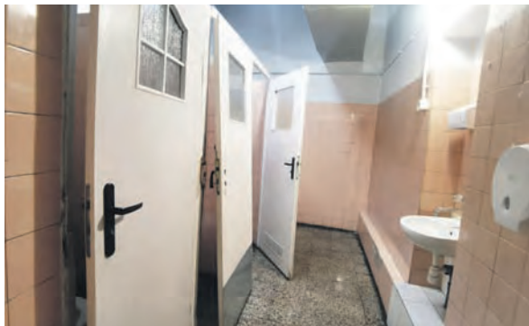
W łazience Dworca Głównego w Łowiczu od toalet poodrywane są drzwi.
