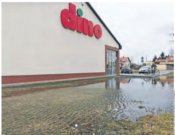
Po deszczach woda zbiera się także przy ścianie szczytowej budynku.
