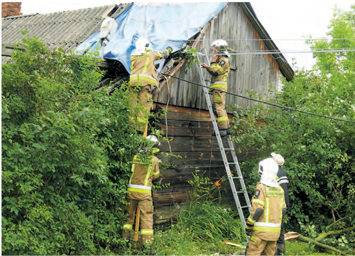
Po nawałnicy z 14 na 15 lipca 2021 r. strażacy z OSP Pilaszków zabezpieczają dach, w który wbił się złamany słup energetyczny.
