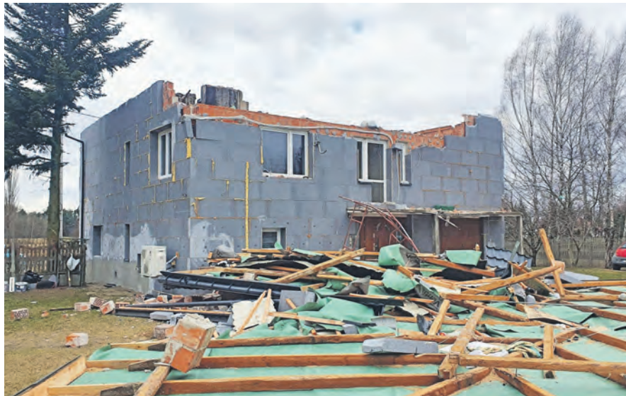
W Jasionnej w gminie Bolimów sobotni wiatr całkowicie zerwał dach, powodując poważne uszkodzenia budynku.
