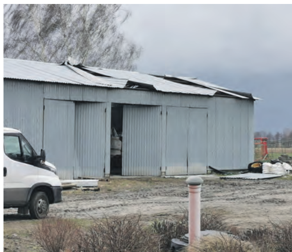
W Kocierzewie Północnym wiatr uszkodził dach wiaty garażowej dla maszyn rolniczych rodziny Jabłońskich.
