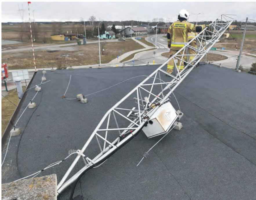
To również dach strażnicy w Lwówku w gminie Sanniki, na którym przewrócił się stojący tu maszt.
