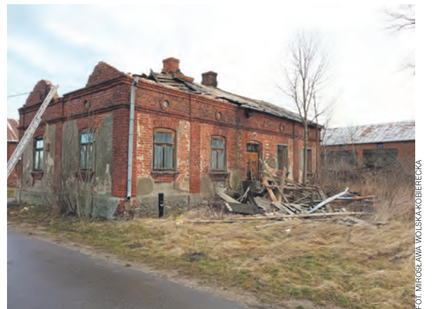
W tym budynku w Chruślach uszkodzony został zarówno dach, jak i szczyt. Mieszkający w nim mężczyzna spał w części, która ocalała.
