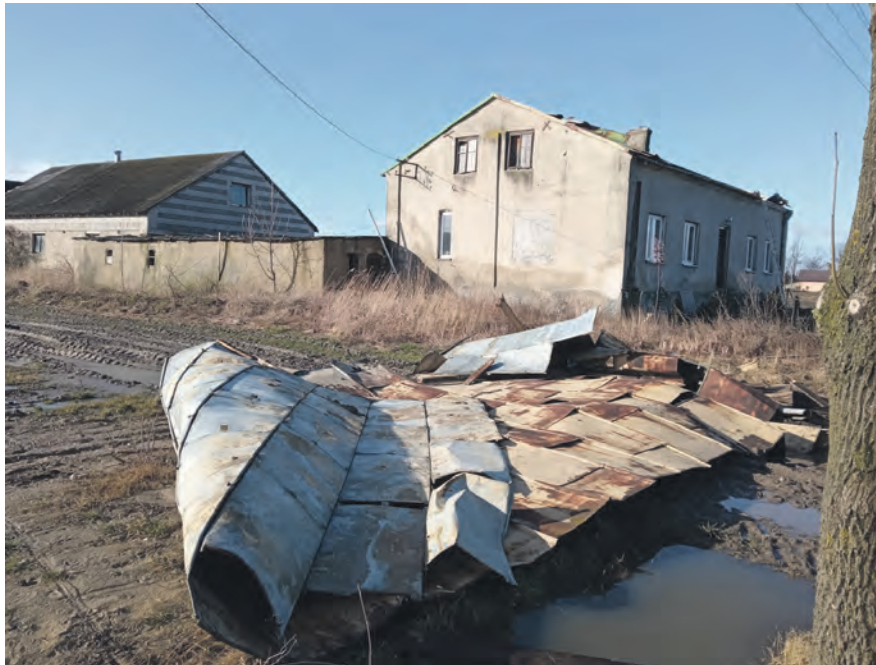
Zerwana blacha z dachu rodziny Żaczków w Brodnym Towarzystwie poleciała kilkanaście metrów dalej. To zdarzenie miało miejsce 17 lutego.
