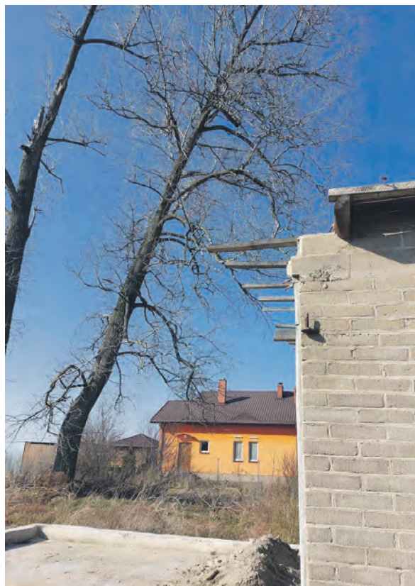
Uszkodzony garaż, nad którym pochylają się uschnięte drzewa. Zagrożony może być też teren świetlicy wiejskiej w Starych Grudzach (na drugim planie).
