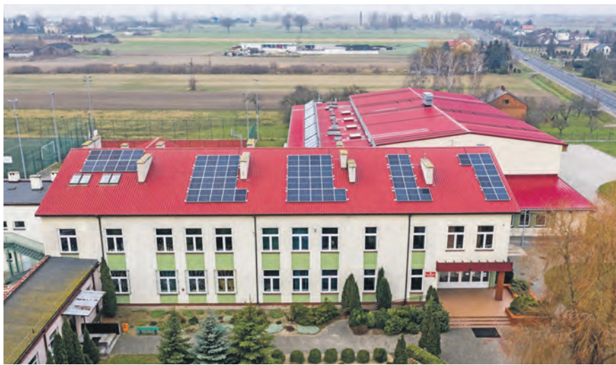
A tak prezentują się panele fotowoltaiczne zamontowane ponad rok temu na gmachu Szkoły Podstawowej w Nowych Zdunach.
