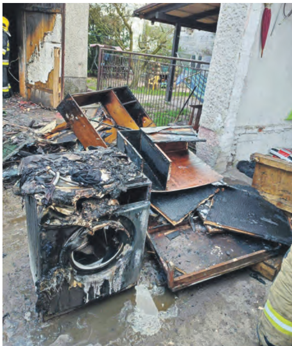
W wyniku pożaru zniszczeniu uległo wyposażenie kotłowni. Straty oszacowano na 20 tys. zł.
