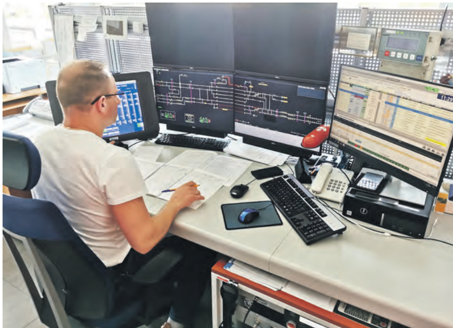
Stanowisko dyżurnego ruchu w nastawni, a w przyszłości Lokalnego Centrum Sterowania na dworcu PKP Łowicz Główny.
