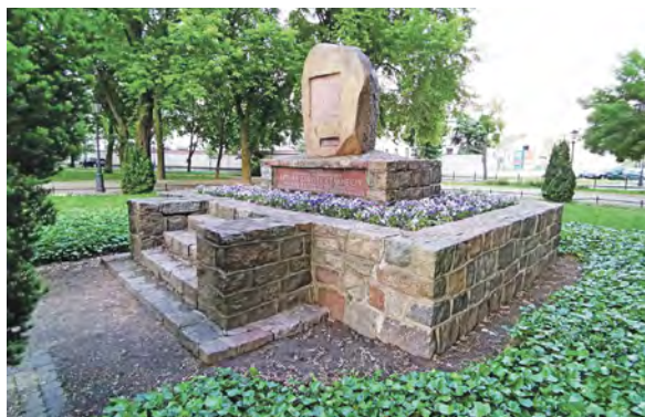
Pomnik Zawiszy Artura Czarnego w parku Błonie, w ostatnich latach jego zachodnia ściana wyraźnie zaczęła osiadać.
