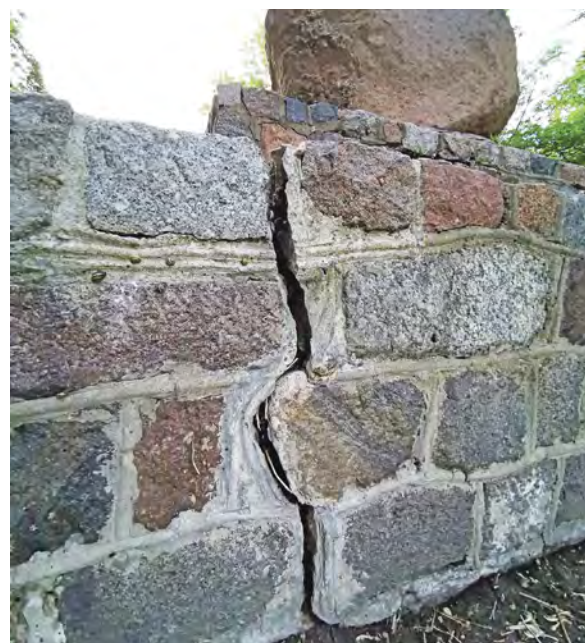
Na ścianie od strony południowej pojawiło się wyraźne pęknięcie, które z roku na rok robi się coraz szersze.
