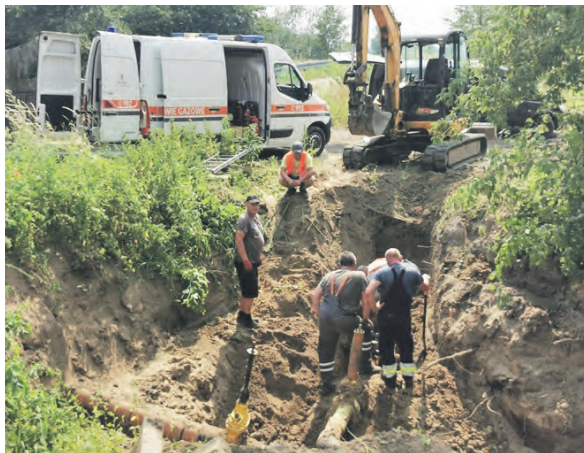
Podczas prac ziemnych z użyciem koparki doszło do uszkodzenia gazociągu.
