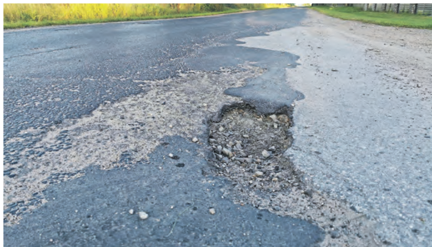
Droga przez Jasionną w gminie Bolimów jest w złym stanie – teraz będzie poprawiona.
