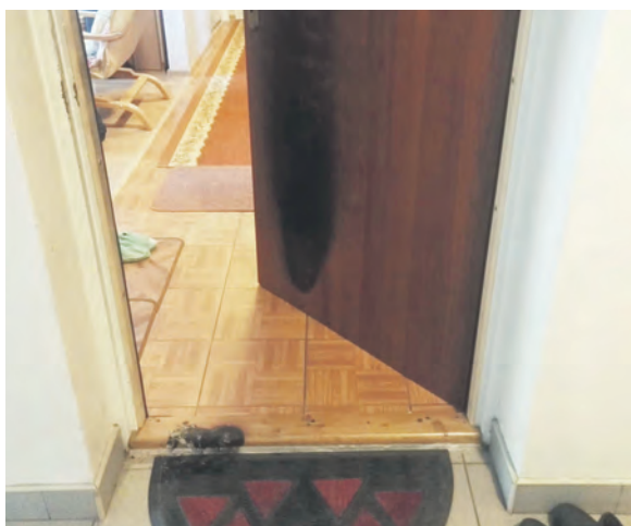
W wyniku podpalenia zniszczeniu uległy drzwi oraz próg mieszkania.
