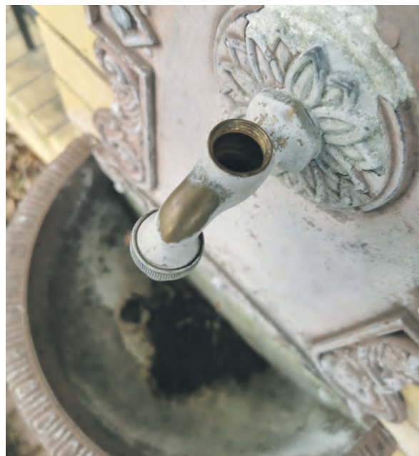
Źródło przy ul. Blich nie działa, więcej jest uszkodzony i zanieczyszczony.
