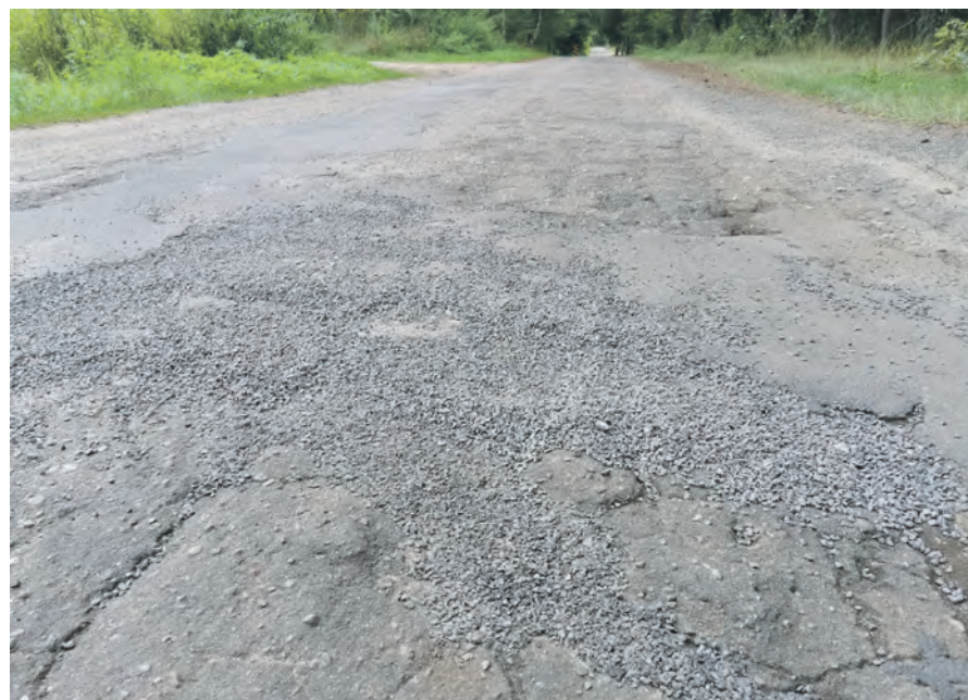
Łatanie dziur na Leśnej grysem, przeprowadzone w ubiegłym tygodniu, nie zmienia stanu tej drogi.
