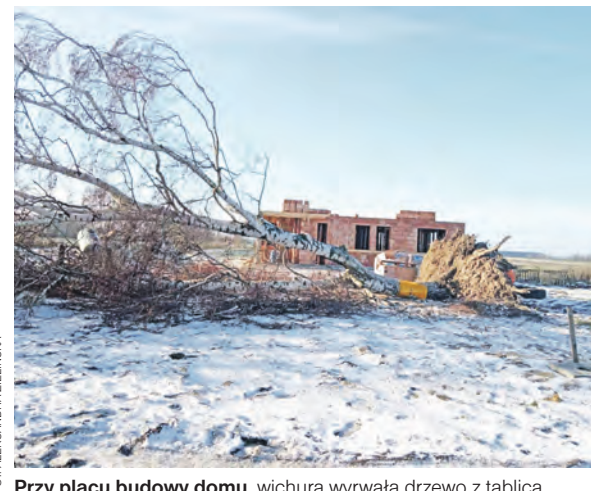
Przy placu budowy domu, wicherza wyrwała drzewo z tablicą informacyjną o budowie.
