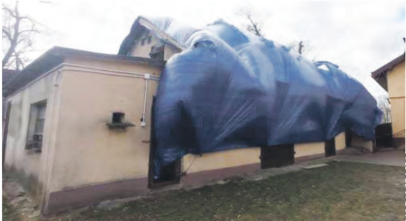
Zerwany dach na budynku Sławomira Bobrowskiego.
