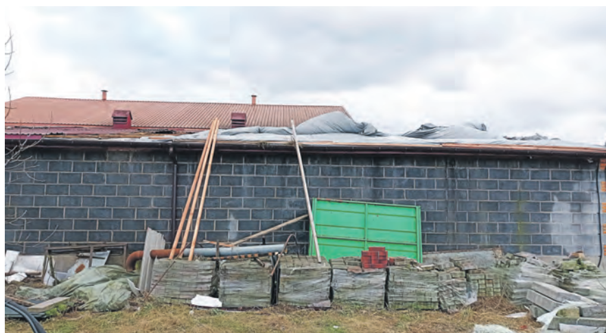
Zerwany dach z obory w Piaskach Starych.
