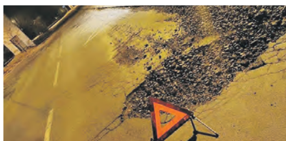
Dziura na ul. Kopernika w Głownie.
