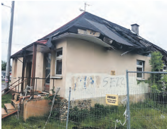
Największym zagrożeniem dla przechodniów są fragmenty pokrycia i konstrukcji dachu.
