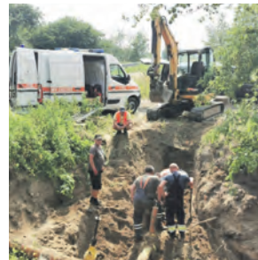
Podczas prac ziemnych uszkodzony został gazociąg.
