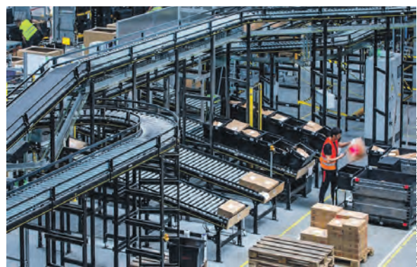
W całym centrum dystrybucyjnym użyto aż 3,5 km przenośników taśmowych.
