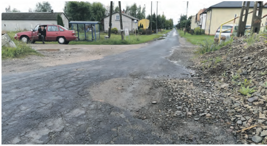
Zniszczona podgrzewana droga przy przejeździe kolejowym w Kęszycach.
