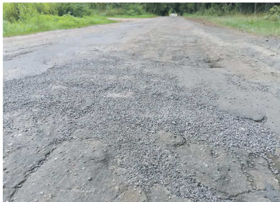
Łatanie dziur na Leśnej grysem, przeprowadzone w ubiegłym tygodniu, nie zmienia stanu tej drogi.
