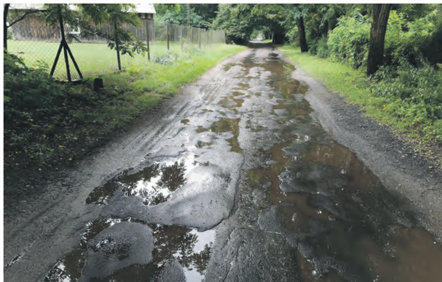
Ulica Leśna w Joachimowie Mogiłach. Spękana i podziurawiona na całej swej długości.
