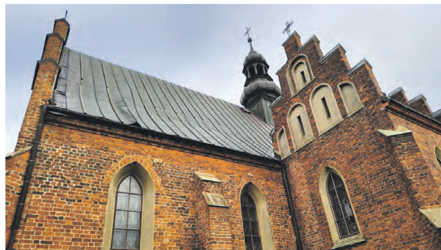
Parafię czeka w najbliższym czasie remont dachu, który pokryty jest blachą miedzianą. Uległa ona uszkodzeniu podczas jednej z zimowych nawałnic.
