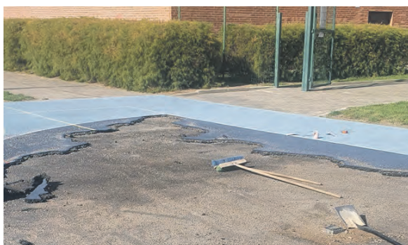
Początkowo zakładano, że ubytki w nawierzchni poliuretanowej spowodowane są naturalnym zużyciem.
